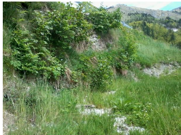
Slika 3: Plaz pod brižino ceste katera je bila sanirana leta 2009
