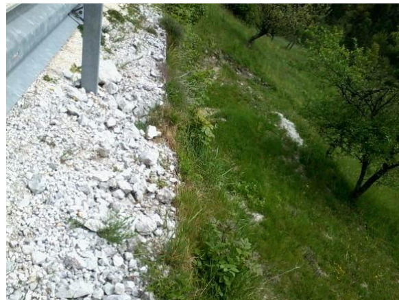
Slika 5: Plaz ogroža sanirani del ceste do kmetije
