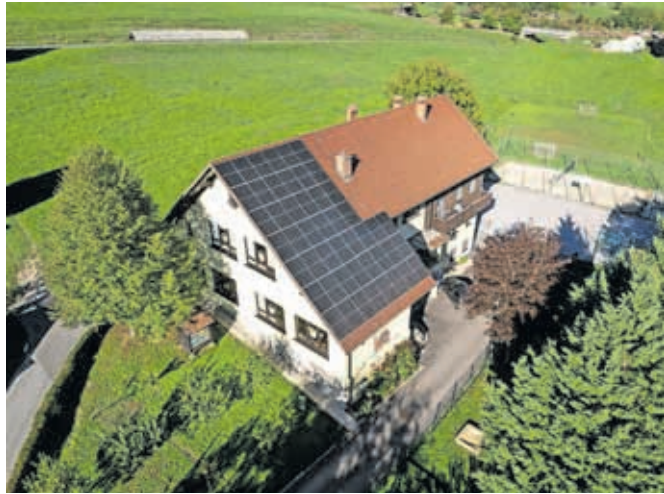
V okviru projekta je bila za energetske učinkovitejše delovanje novega sistema na streho Podružnične šole Motnik nameščena sončna elektrarna moči 15,45 kW.
